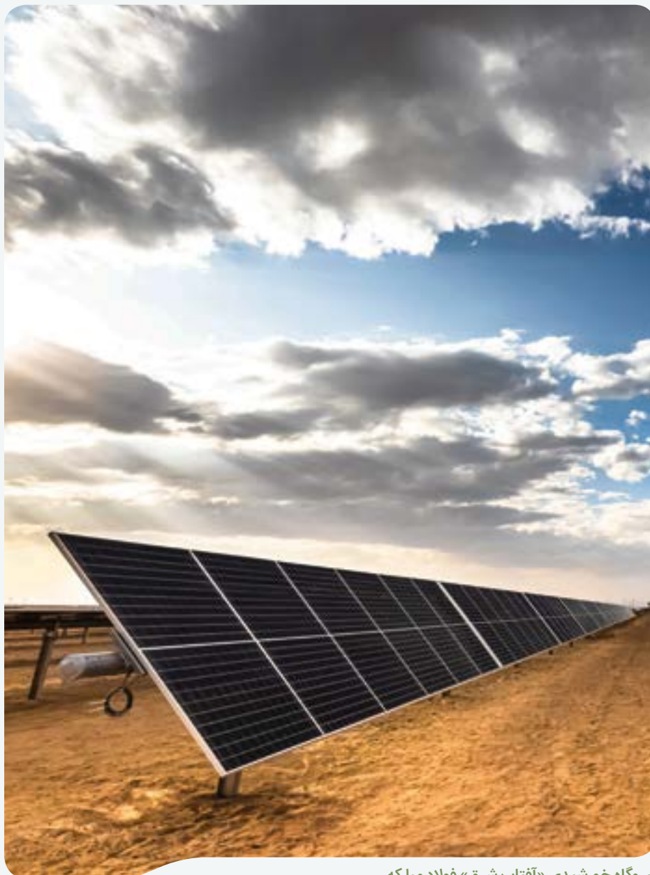
نیروگاه خورشیدی «آفتاب شرق» فولاد مبارکه
